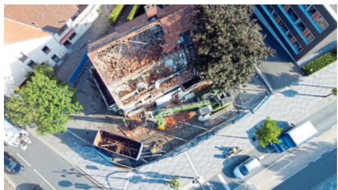
Das Kopshoffsche Haus an der Verler Hauptkreuzung wird abgerissen. Rechts oben ist das Rathaus zu erkennen, links die Hauptstraße.
